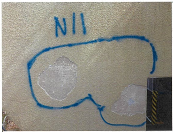
躯体補修 不良箇所・マーキング
