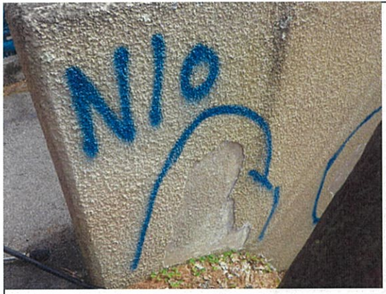
躯体補修 不良箇所・マーキング
