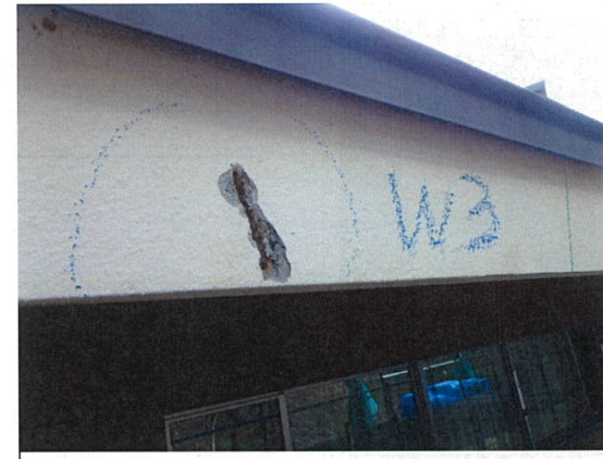
躯体補修 不具合箇所マーキング
