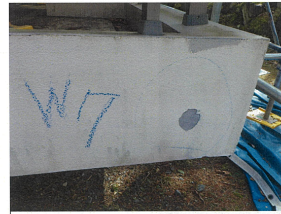
躯体補修 不具合箇所マーキング
